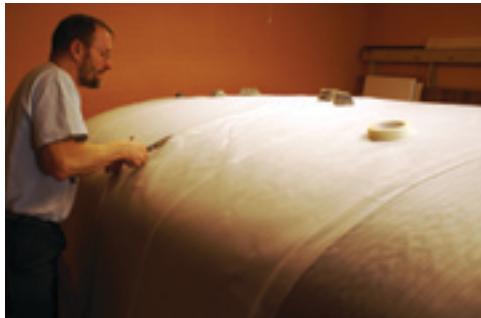
Overgangene klippes til, så højden på laminatet bliver så jævn som muligt.
